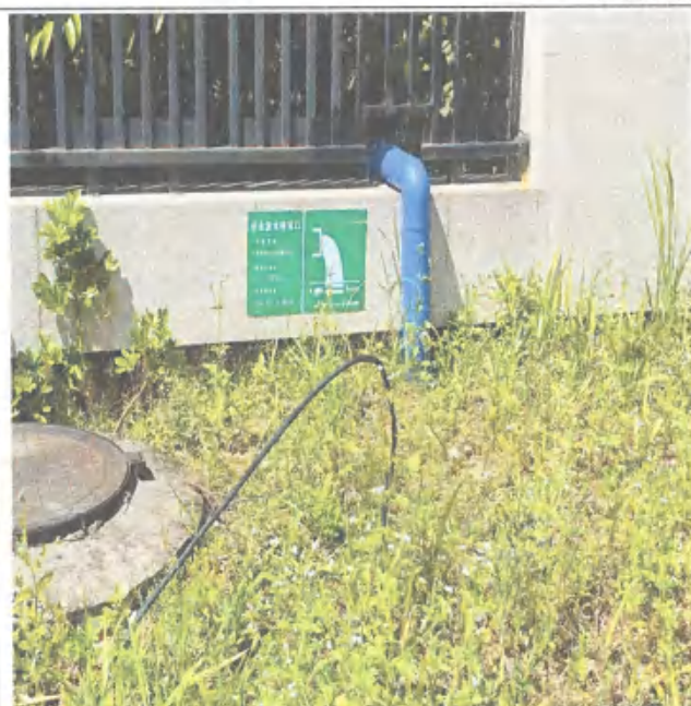
综合废水排放口 DW001
