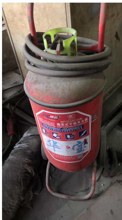
应急消防设施
