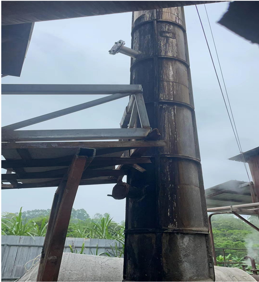
废气处理后采样检测口
