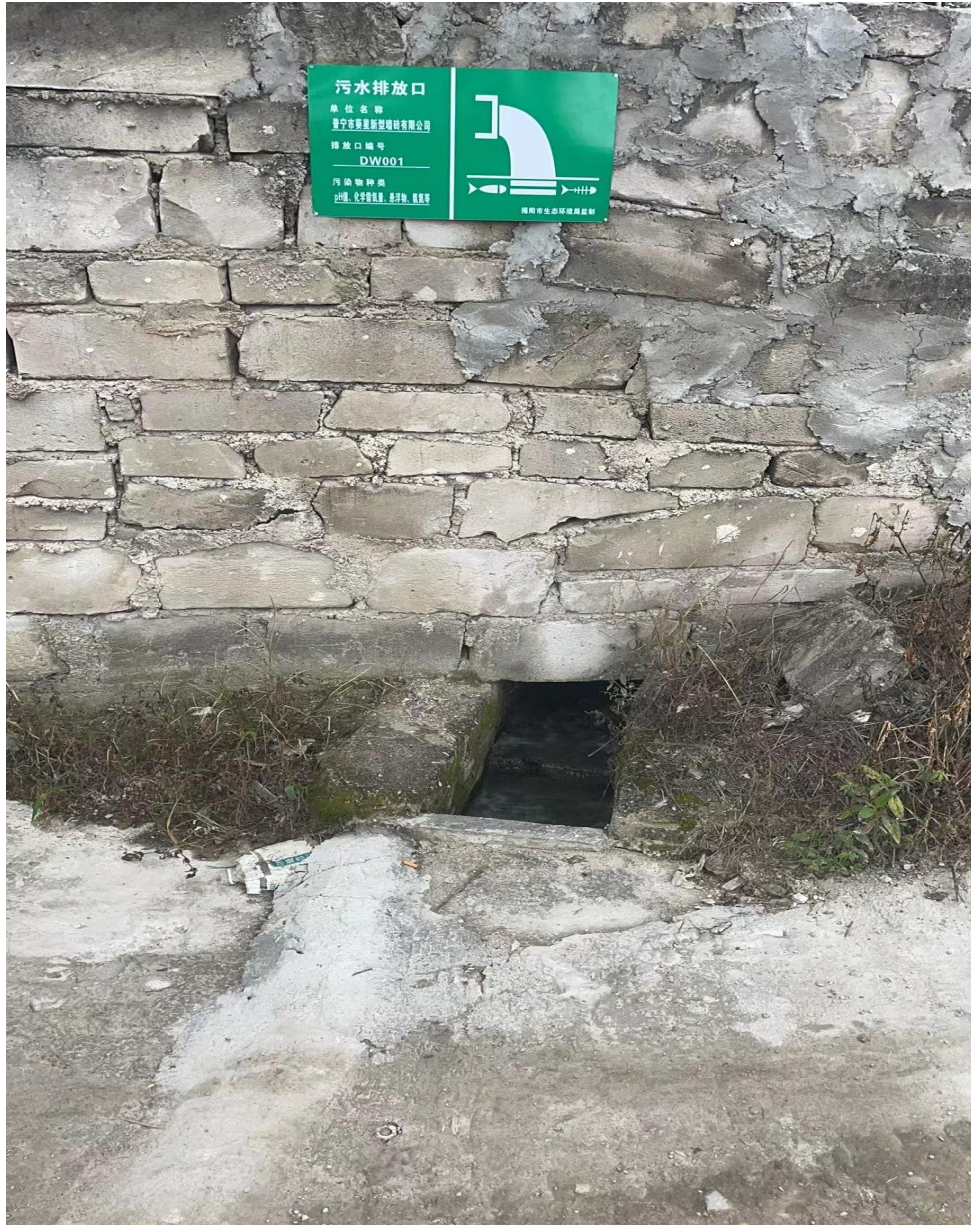
生活污水排放口
