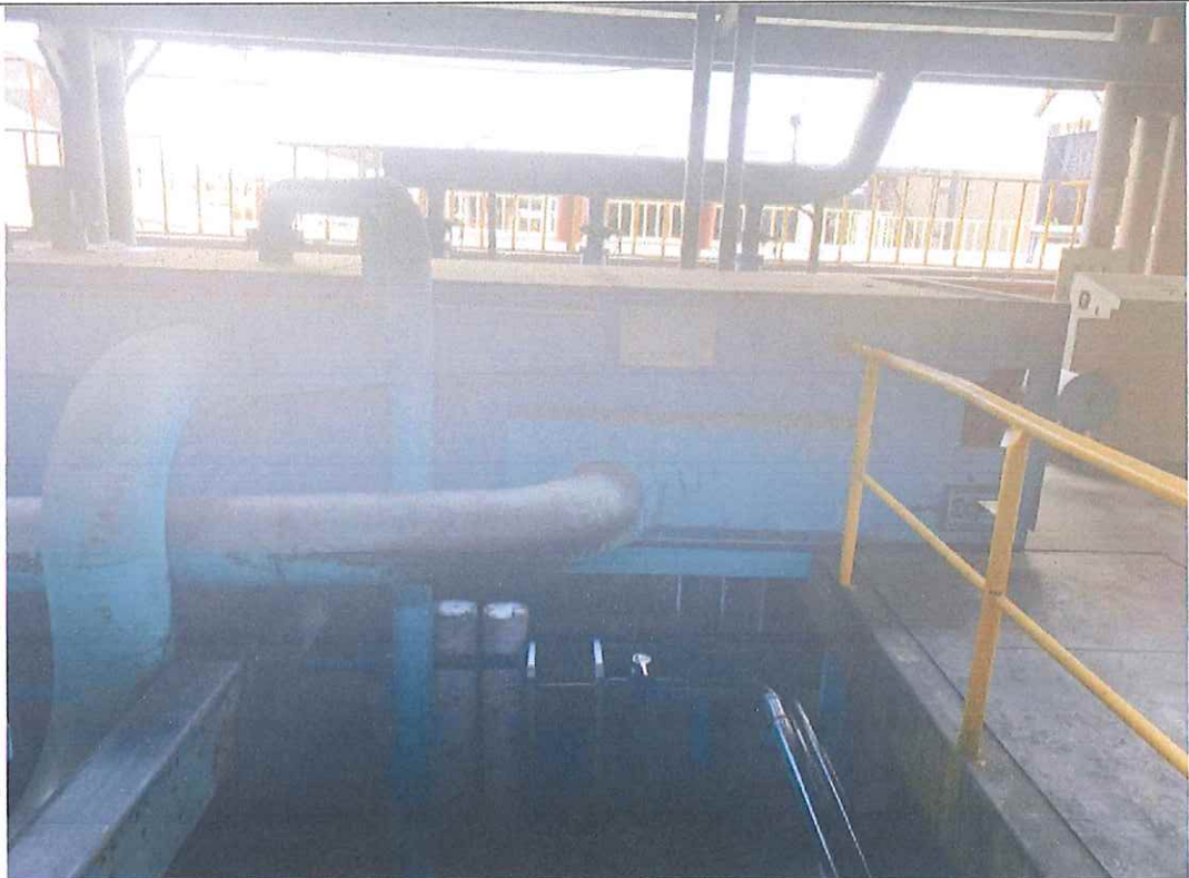
废水处理设施
