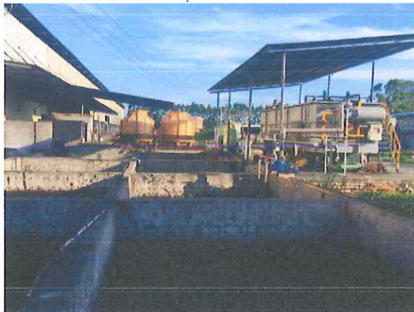
废水处理设施
