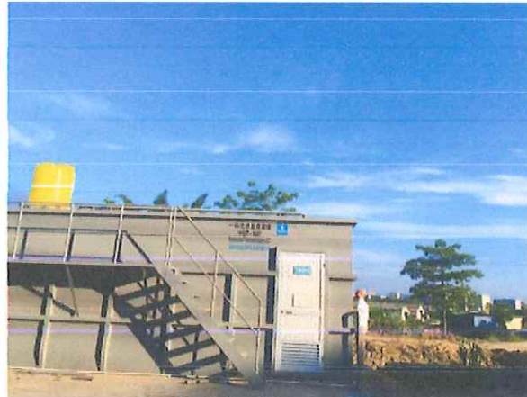
一体化污水处理设施
